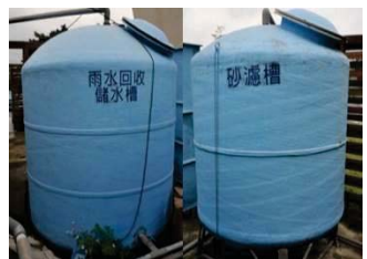
永和營運中心雨水回收儲水槽
